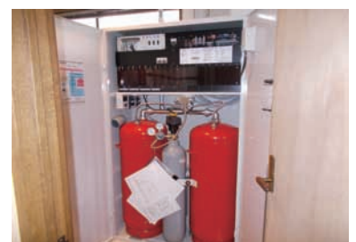
パッケージ型自動消火設備
